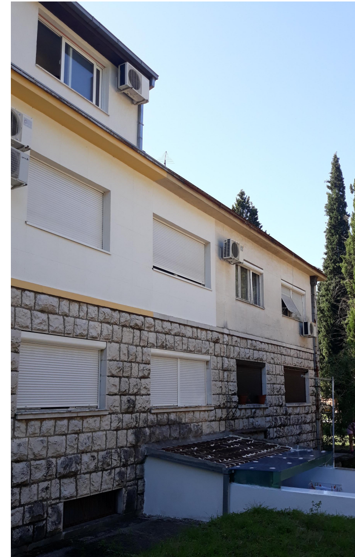
FOTO 02a. POSTOJEĆE STANJE
