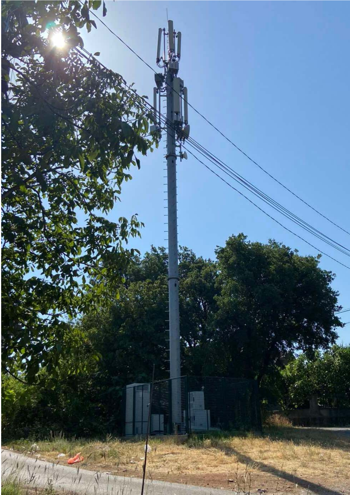
Slika 1 - Fiksna radiokomunikaciona stanica "Vranići"
